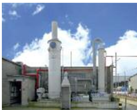
Scrubbertoren voor ethyleenoxide.
