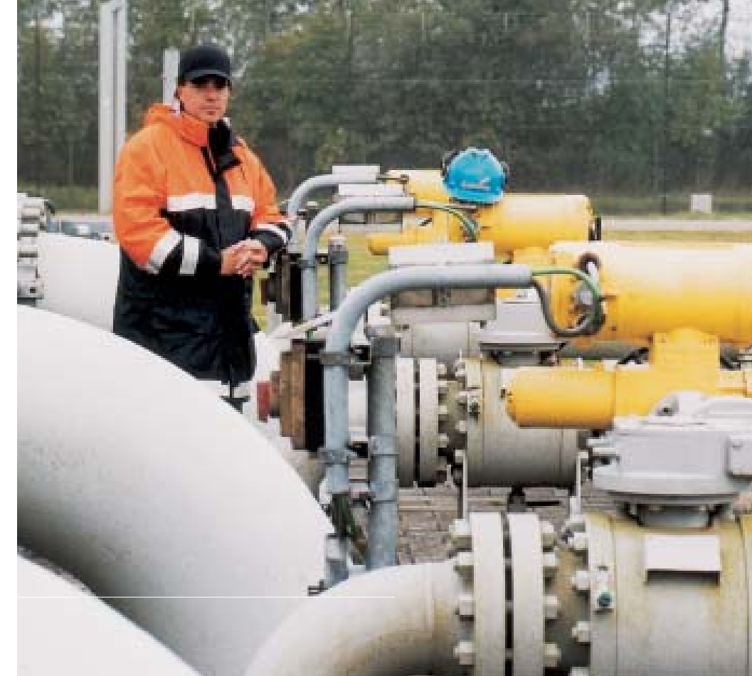
Hoofdtechnicus Peter van Elferen op de plek in de Wieringermeerpolder waar Noordzee-aardgas dag in dag uit samenkomt met stikstof uit de luchtsplitsingsfabriek in IJmuiden.
